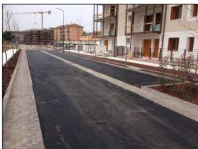
foto materiale - manto di usura in conglomerato bituminoso e fasce laterali in cubetti di porfido per contenimento cadutoie (foto OOU 1°stralcio)
